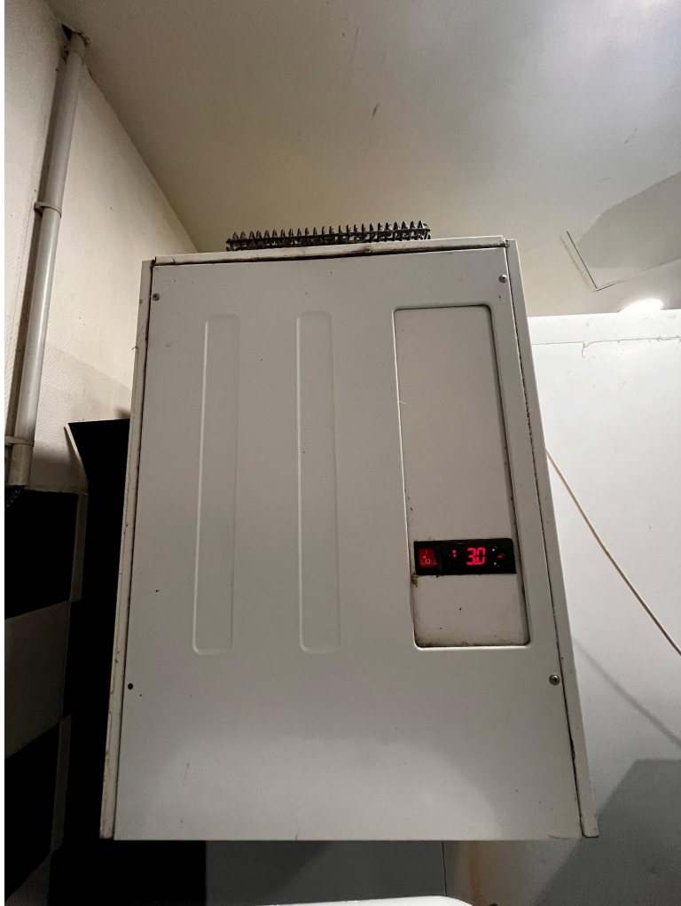
Bloc moteur chambre froide
